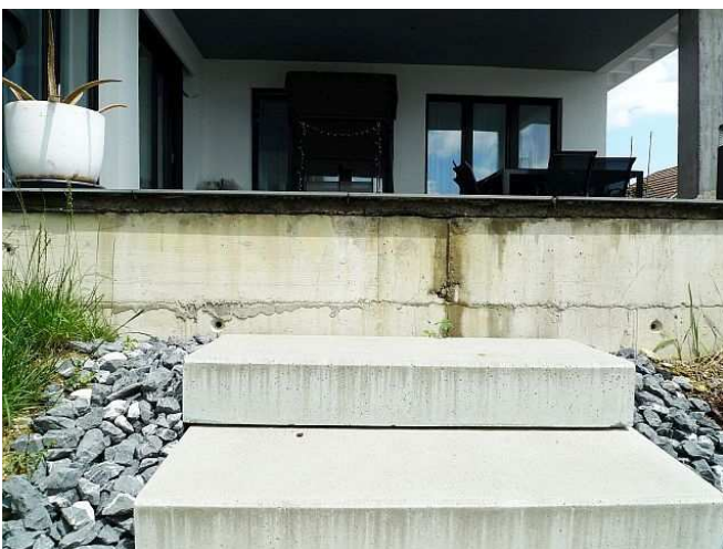
11 Treppenabschluss zu tief
