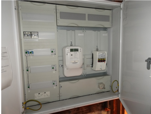
DG Estrich Elektrotabelleau
