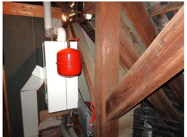
DG Gasheizung ost
