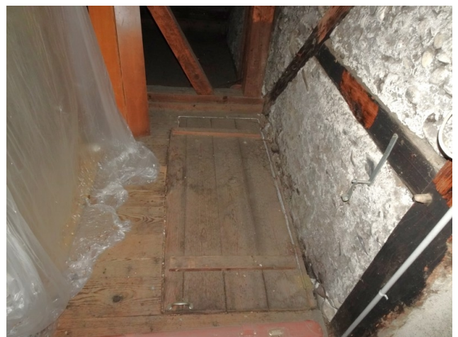
DG Treppenklappe von Zimmer OG nord ex 29
