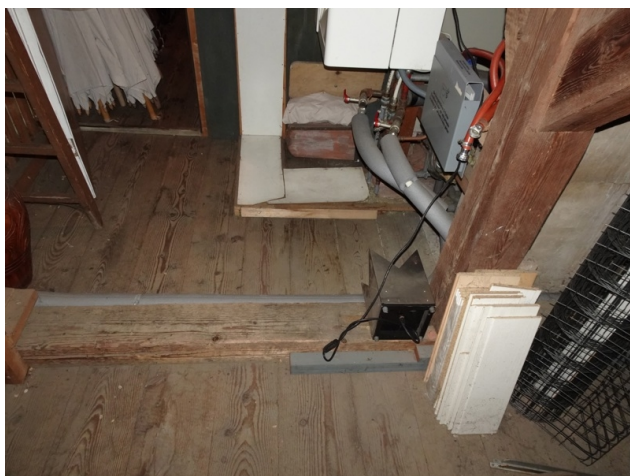
DG Gasheizung ost
