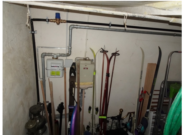
UG ex Nr. 29 Keller nordost Leitungen
