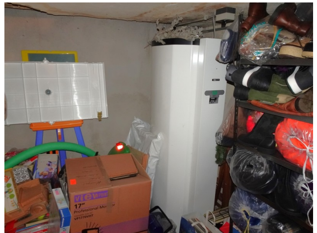
UG ex Nr. 29 Keller nordwest Boiler
