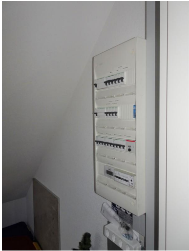
Technik südwest Elektroverteilung
