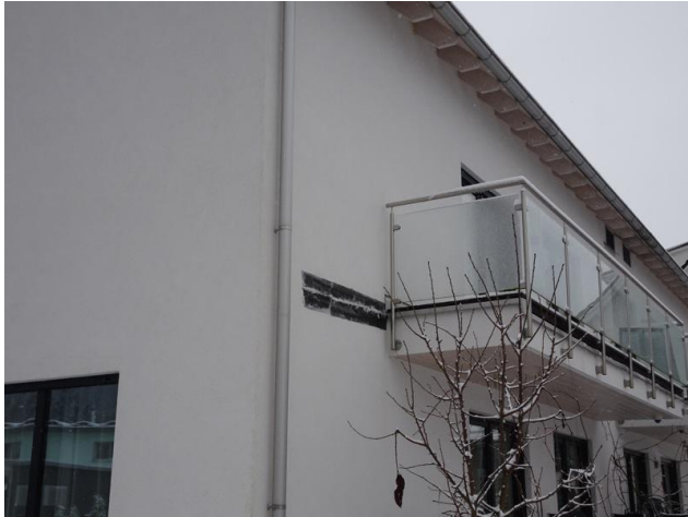
Defekte Fassade westseitig
